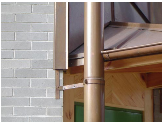
Fot. 5 Obejma pióra mocowana do muru
