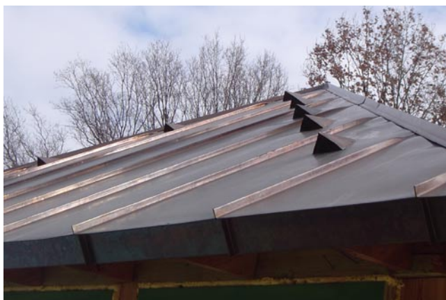
Fot. 3 Szereg wywietrzników połaciowych. W każdym siatka zabezpieczająca
